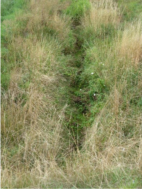
Bild 14: Blick auf den Seerennengraben mit ausgetrockneter Sohle (Anfang September 2022) oberhalb der Brücke des Feldwegs
